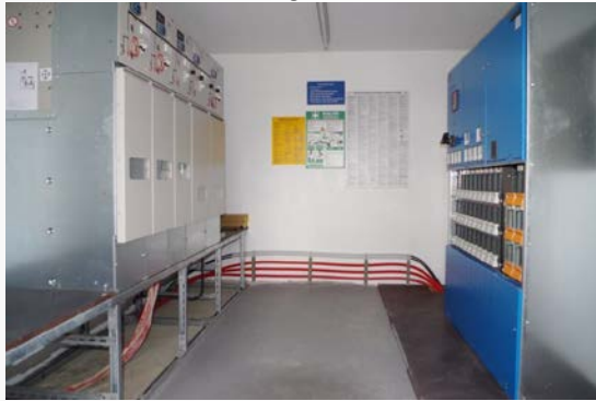
Nach Umbau MS/NS-Anlagen neu
